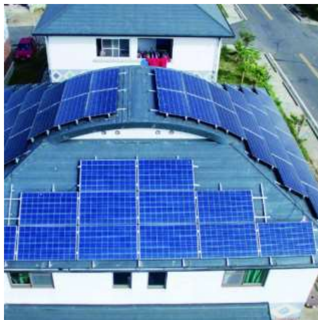
圖 2-86、嘉義縣逐鹿社區-光電設施現場照片
