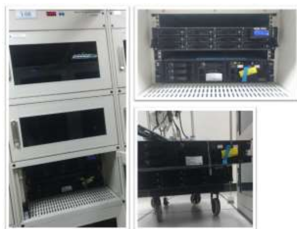
圖 2-43、北部東七機房移機後現地設備
